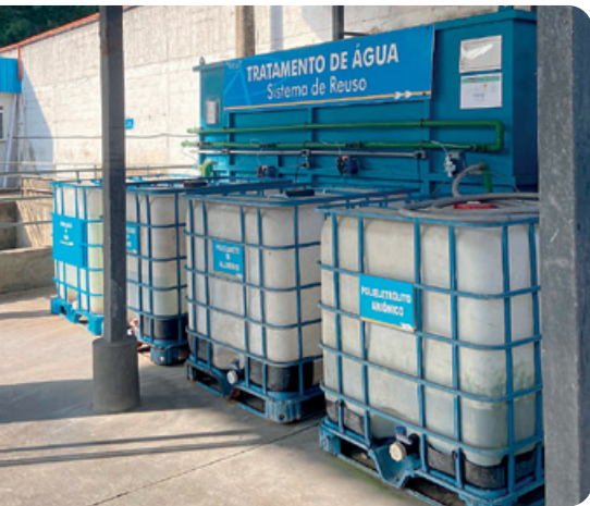
Sistema de reuso de água da Viação Nossa Senhora do Amparo
